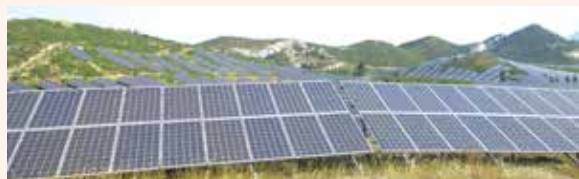
河北临城光伏扶贫电站
